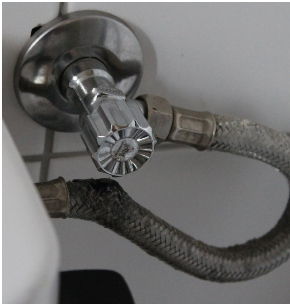
Leitungswasserschäden treten sehr häufig auf
